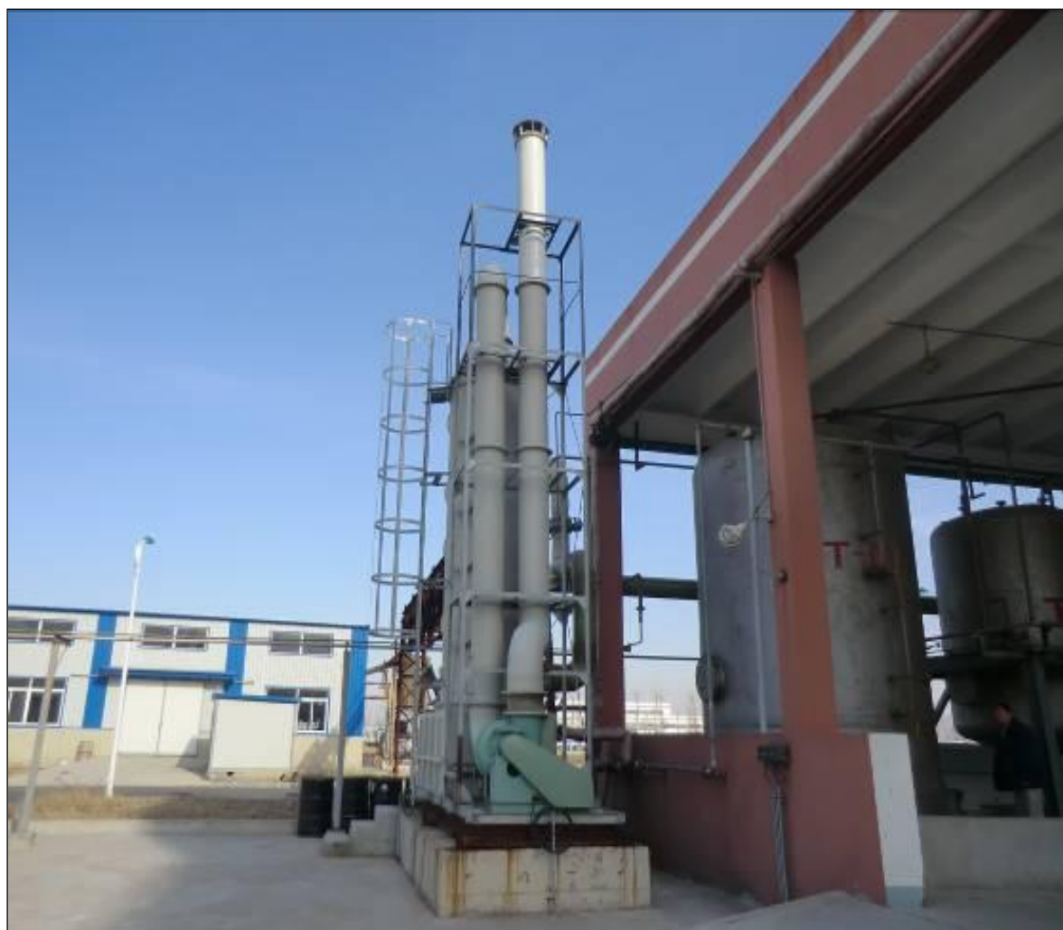
氯化苦尾气处理洗净塔
