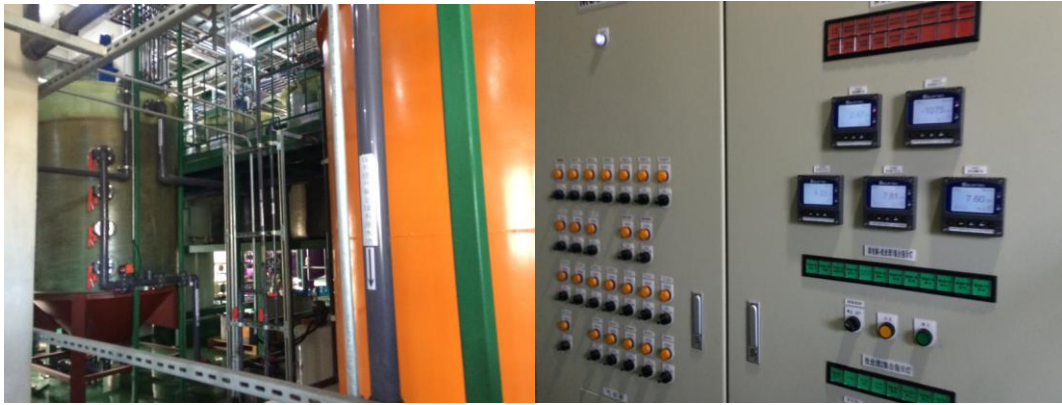
废水处理装置
