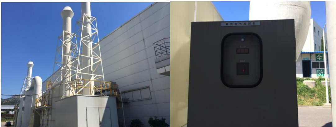
废气处理装置
